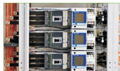
Int. caja moldeada + analizador de redes
